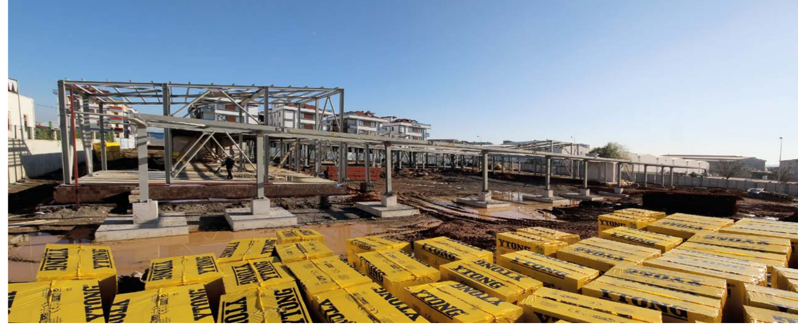
Sancaktepe İşitme ve Konuşma Engelliler Eğitim ve Rehabilitasyon Merkezi İnşaat aşamasından bir görsel
