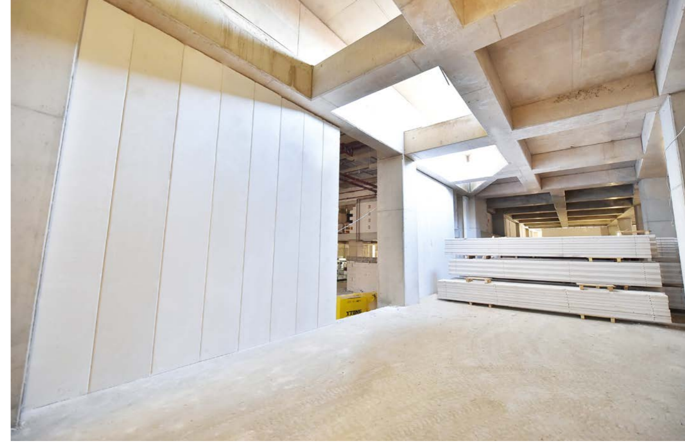
Anatolium Marmara Alışveriş Merkezi projesinde, Ytong panelleri ile duvar uygulama aşamasından bir görünüm.
